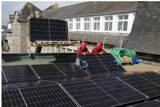
Panneaux photovoltaïques Curie
